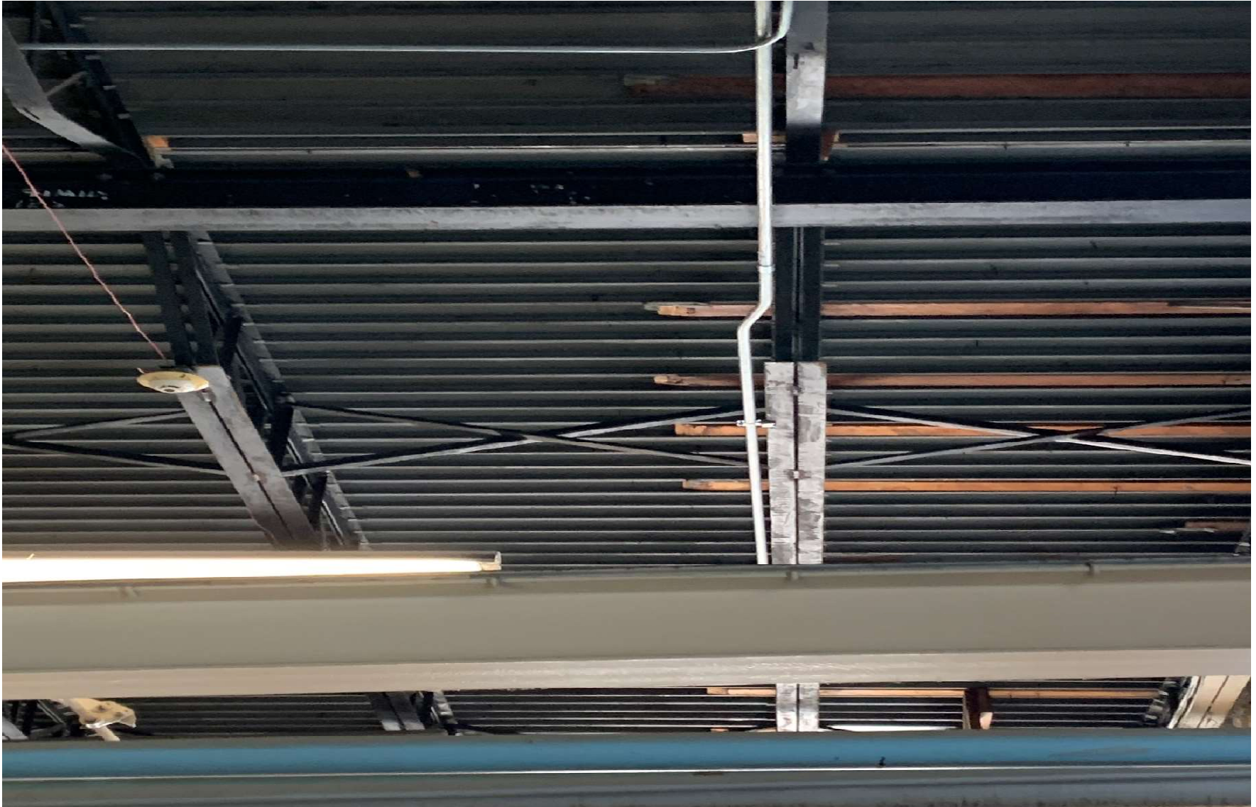
Electrical Power Feed Conduit
